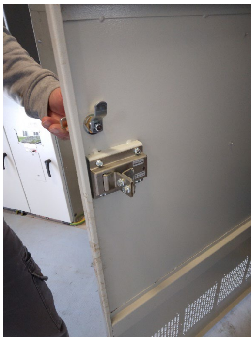
Fig. – Porta danneggiata box trasformatori linea 1-2
